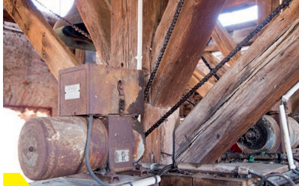
La plupart des cloches sont dotées du moteur d'entraînement de l'époque. Construits pour durer !
